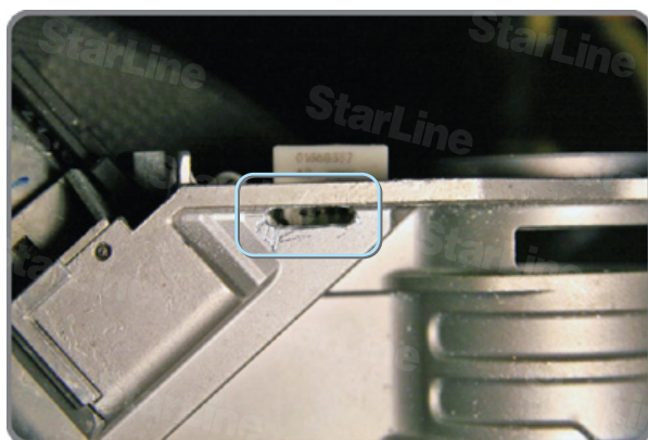
Фото 9. Отверстие для проводов
