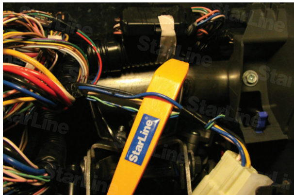
Фото 14.1. Питание сигнализации (+12В синий)
