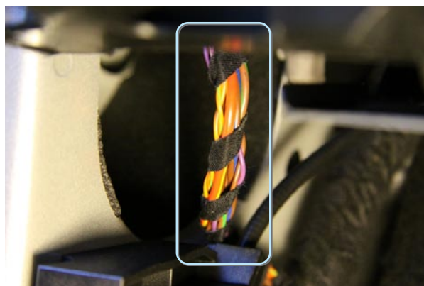
Фото 10.1. Жгут проводов в левой кик-панели
