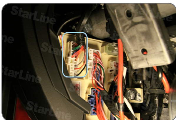
Фото 13.1. Блок предохранителей и разьем ЦЗ
