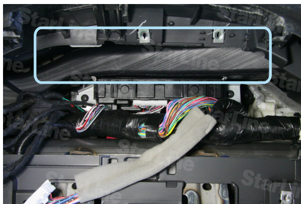
Фото 5. Место установки блока сигнализации
