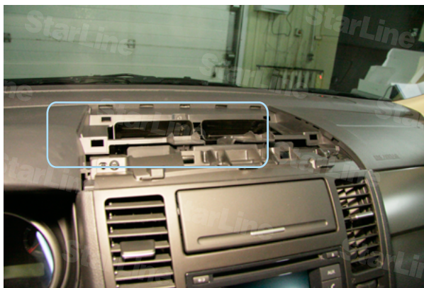
Фото 5. Место установки блока сигнализации
