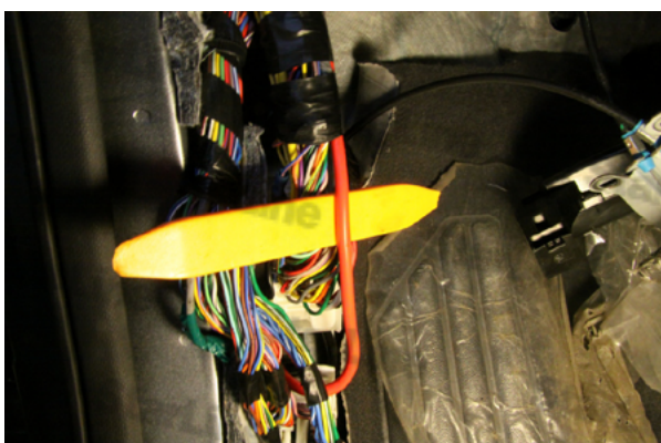
Фото 13. Постоянный плюс (красный)
