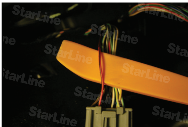
Фото 9. Общий провод концевиков дверей и багажника
