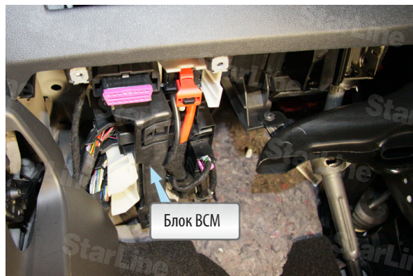
Фото 12.1. Месторасположение блока BCM
