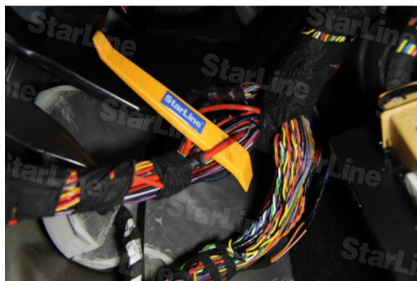
Фото 9.2. Постоянный плюс (красный), (вид сбоку)
